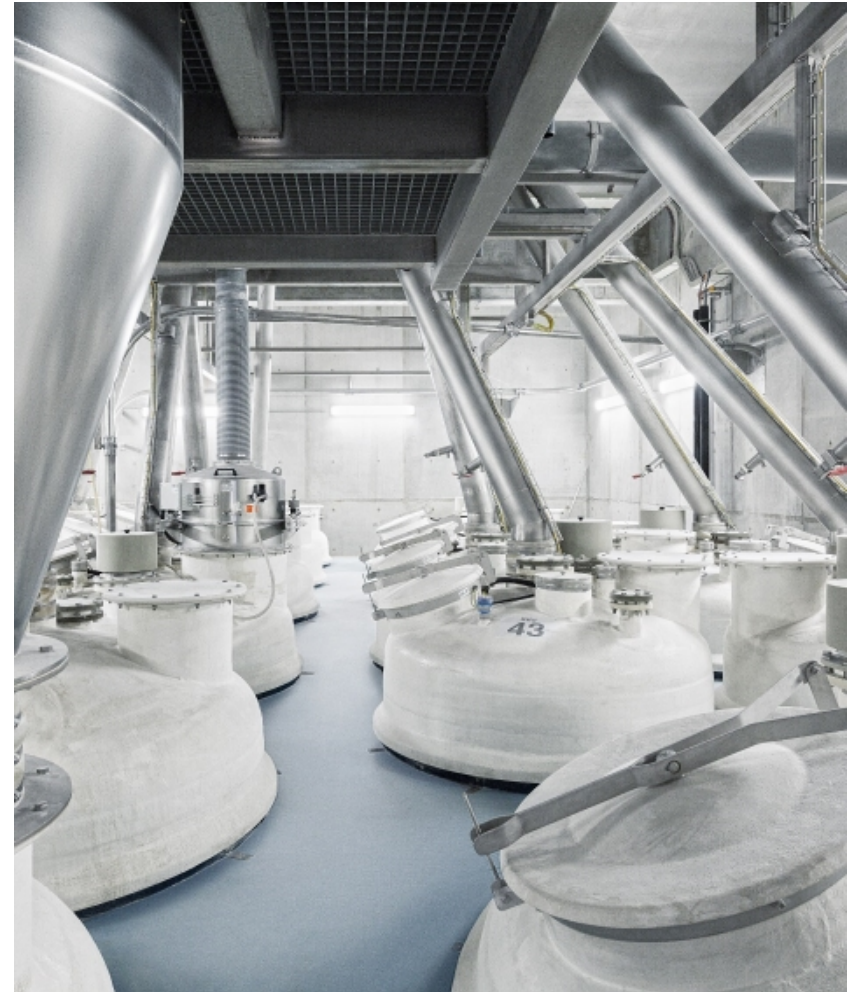
Befüllung der Speisesalzsilos
